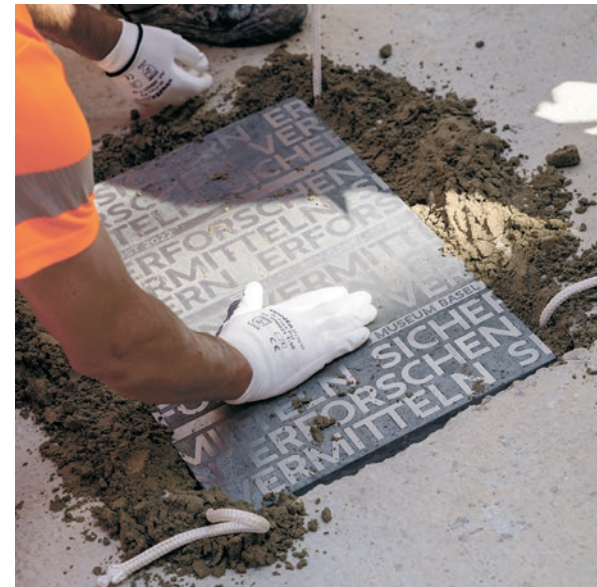
Am 22. August 2022 wurde der Grundstein des neuen Naturhistorischen Museums Basel und des Staatsarchivs im Gebäude an der Entenweidstrasse in Basel gelegt. Regierungspräsident Beat Jans, die Vorsteherin des Baudepartements, Esther Keller und die Architekten des Büros EM2N feierten diesen Meilenstein gemeinsam mit den Nutzerinnen und Nutzern sowie der Quartierbevölkerung.
